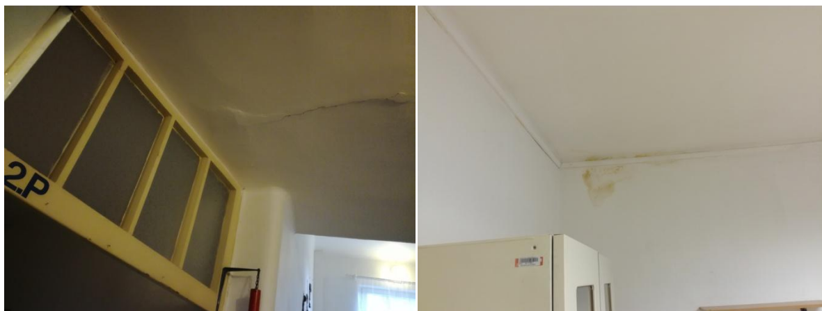
Obr. 16 Pukliny a vlhkost
