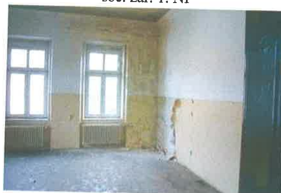
poškozená omítka 2. NP
