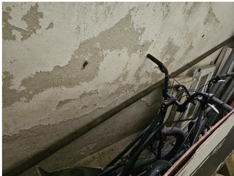
VLHKOST U PATY VNITŘNÍHO ZDIVA
