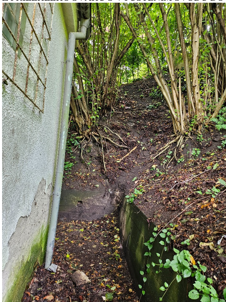
ZANESENÝ PROSTOR V PROLUCE S VIDITELNÝM SPLAVENÍM ZEMINY Z PŘÍLEHLÉHO SVAHU S VYÚSTĚNÍM SVODU DO PROLUKY A VLHKOSTÍ ZDIVA
