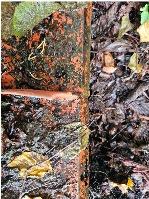
ZKORODOVANÝ PŘESAŘ STŘECHY U ŽLABU BEZ OKAPNICE
