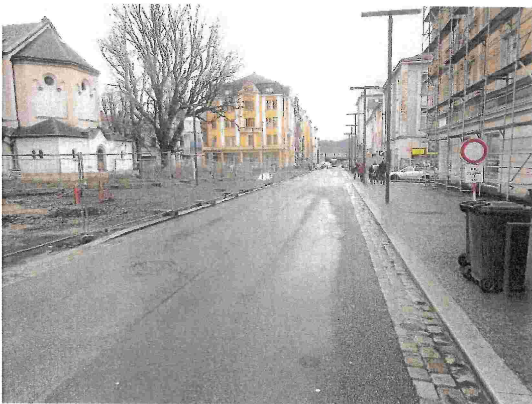
Obrázek 14 – ul. Prokopa Holého – vystupování pojíva na povrch krytu
