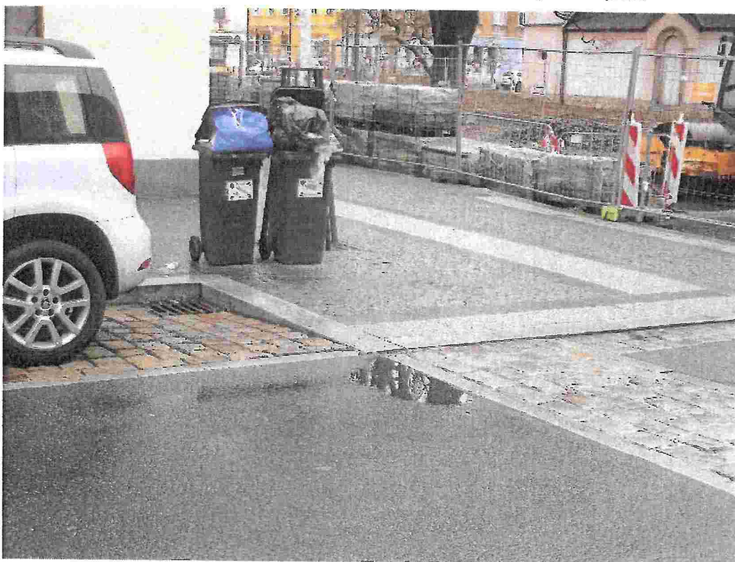
Obrázek 12 – ul. Prokopa Holého – nedokonalé odvodnění u příčného prahu
