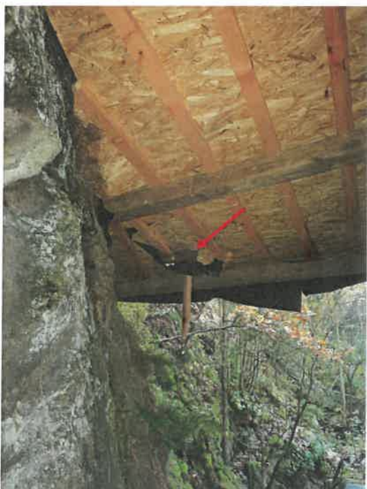
Obr.3 – poškozené zastřešení po pádu bloku
