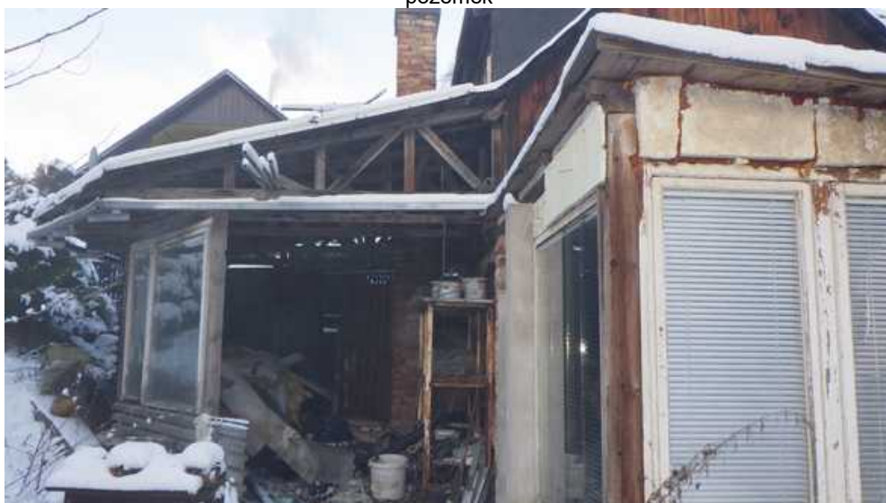
vedlejší černá stavba
