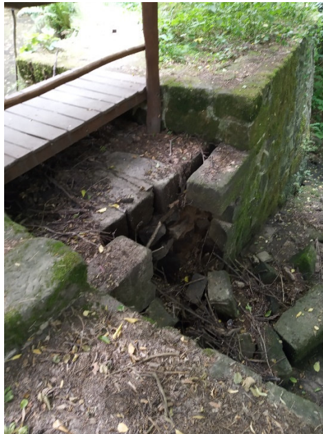
Pohled na rozpadlou vzdušnou přelivnou hranu a zdi u bezpečnostního přelivu
