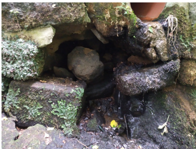
Kaverna pod odpadním potrubím
