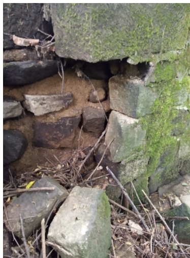
Detail rozpadlého zdiva u bezpečnostního přelivu
