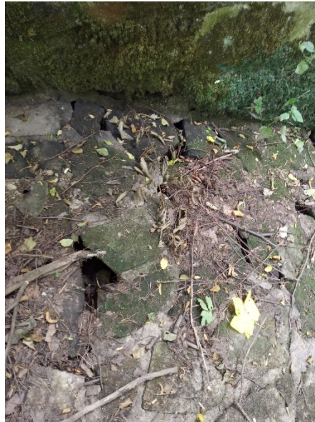
Detail opevnění dna – dlažba z l. k. s vyspárováním – vypadnuté kameny a tvoření výmolů
