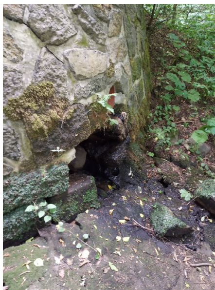
Pohled na zeď na vzdušné straně s kavernou pod potrubím
