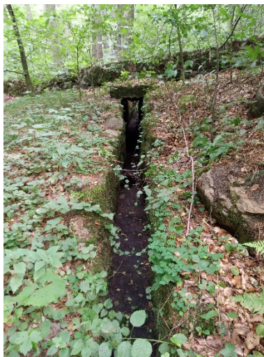
Pohled po toku na propustek pod cestou – vyvalená zeď na levém břehu
